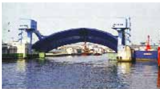
作動中の安治川水門
